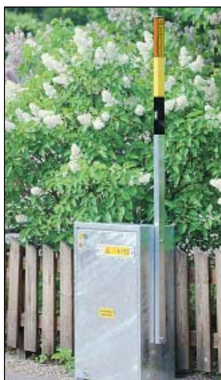
Oznakowanie skrzynek kablowych
