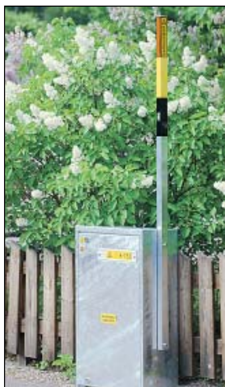
Oznakowanie skrzynek kablowych
